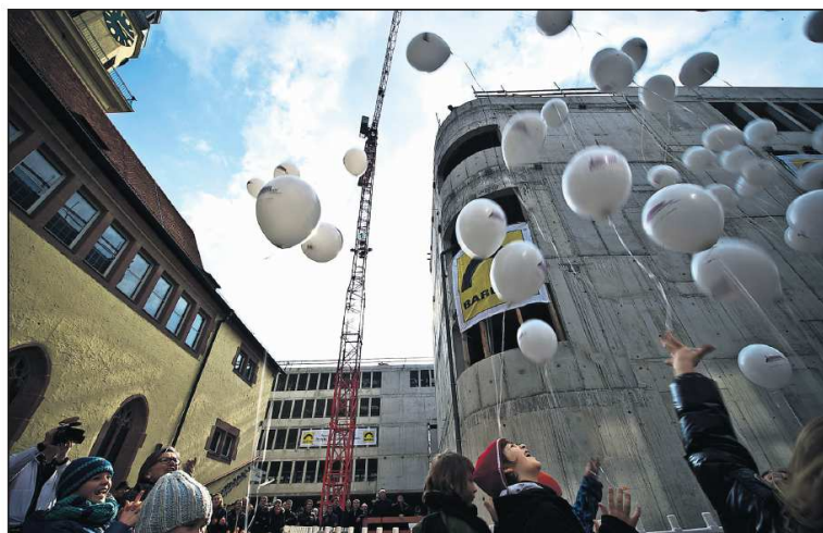
Mehrere hundert Besucher warfen beim Richtfest des Hospitalhofs einen Blick in den Rohbau des Bildungs- und Kulturzentrums. Foto: Max Kovalenko
